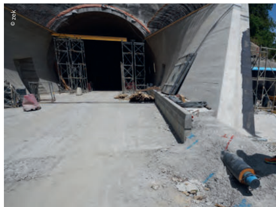
Leitungen von TRM sichern die Löschwasserversorgung sowie die zuverlässige Entwässerung im neuen Umfahrungstunnel.
