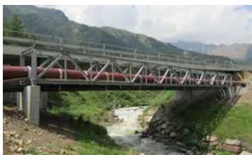
Tubazioni per il passaggio di ponti
