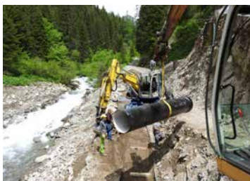
Condotte a turbine
