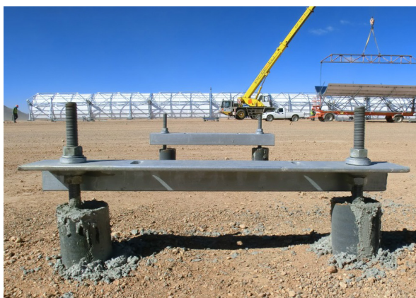
Bolzen mit Unterkonstruktion
