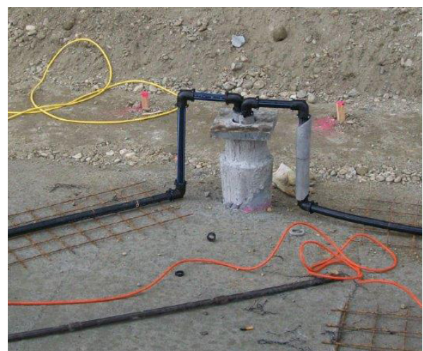
Anschluss der Absorberleitungen
