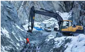
Beschneigungs- und Hochdruckleitungen
