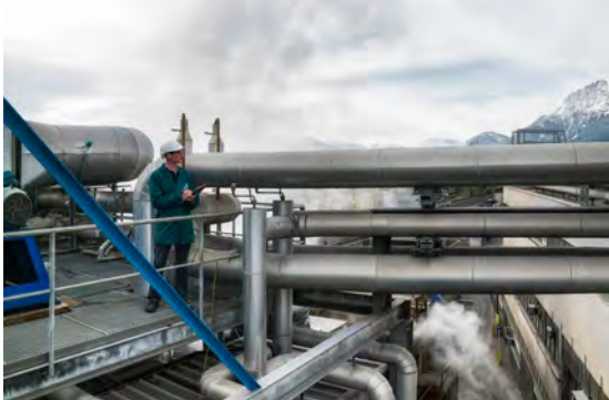
Abluft- und Abwasserreinigung
