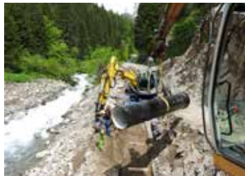
Condotte a turbine
